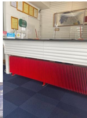
排熱を活用した ヒーターの設置
