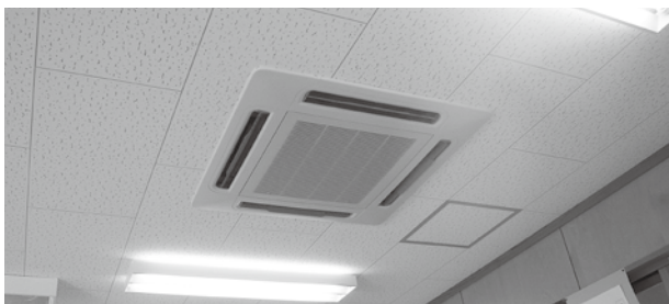
大型エアコンが2基設置されている普通教室(赤泊小学校)
