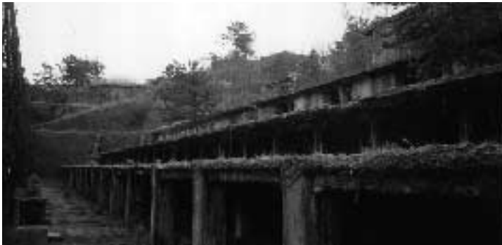
現在の写真 屋根が無く朽ちている 北沢浮遊選鉱所跡
