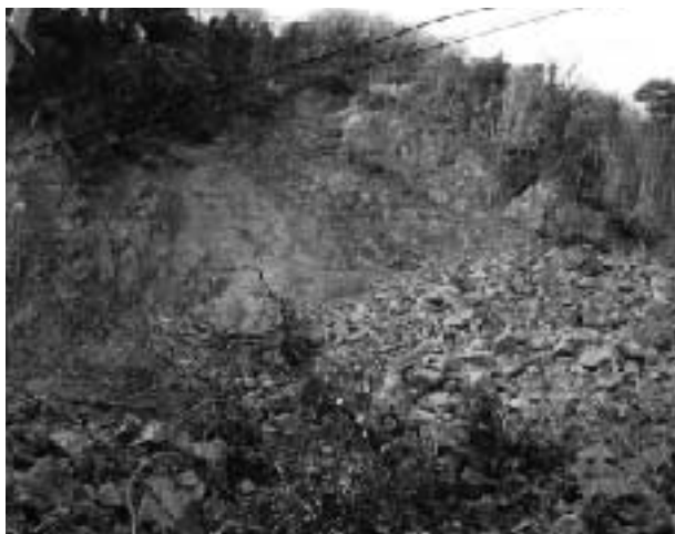
2月11日大崩落した県道岩首～松ヶ崎間
