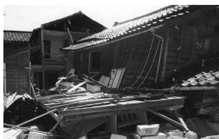
中越地震による倒壊家屋の現状
