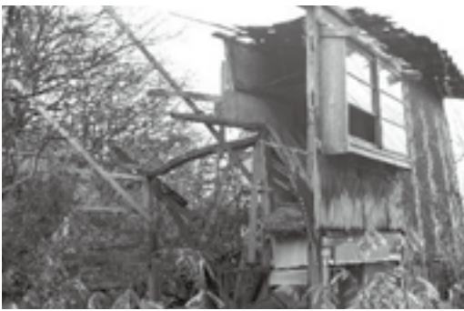
金銀山散策路上に放置されている危険老朽家屋
