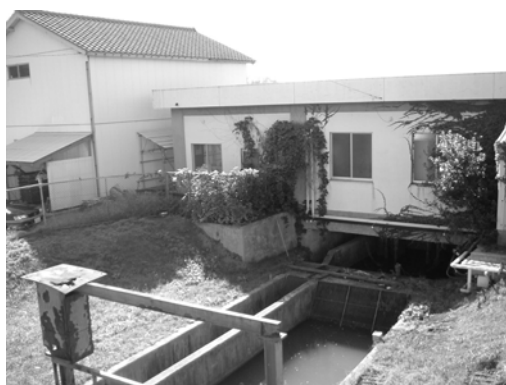
平成6年4月から稼動している湊湖岸公園排水路浄化施設
