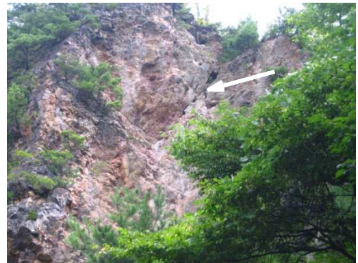
4 節理に沿った亀裂（左写真右側・←部分）
