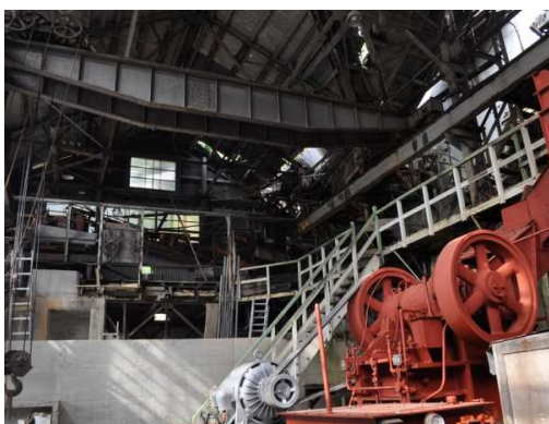
7 粗砕場建物内機械及び天井クレーン
