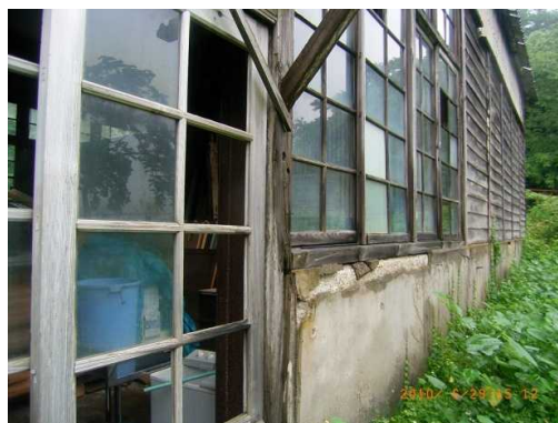
14 分析所窓破損状況
