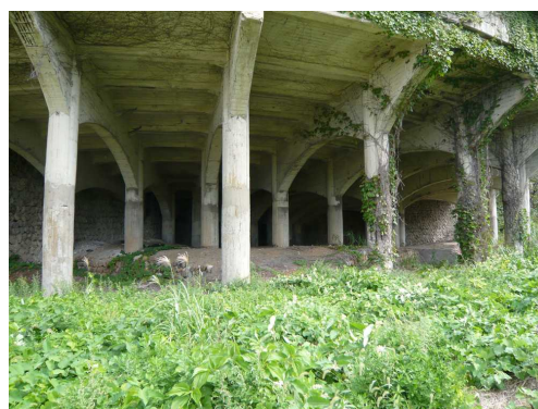
6 シクナー 植物による浸食及びコンクリートの劣化
