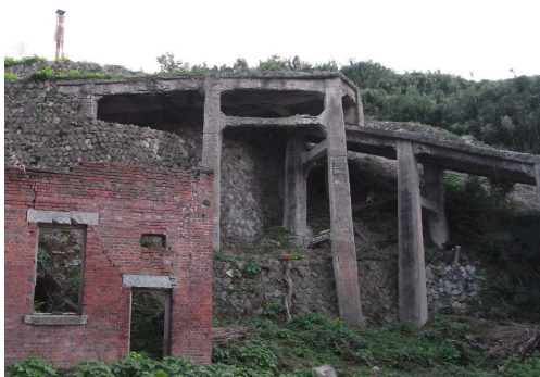
11 インクライン コンクリート劣化部
