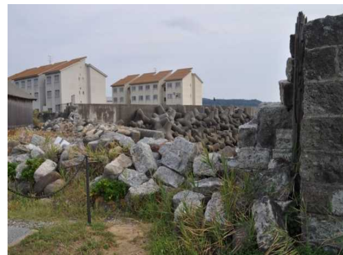
14 崩落状態の石材ブロック
