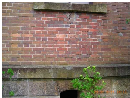
8 火力発電所発電機室 煉瓦壁面亀裂部
