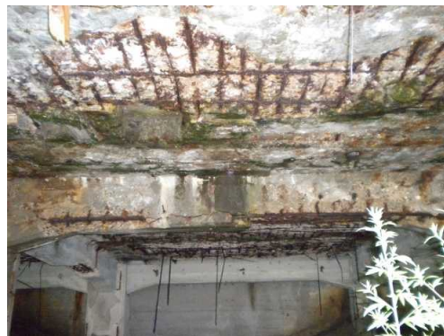
2 浮遊選鉱場跡 RC部鉄筋の爆裂部
