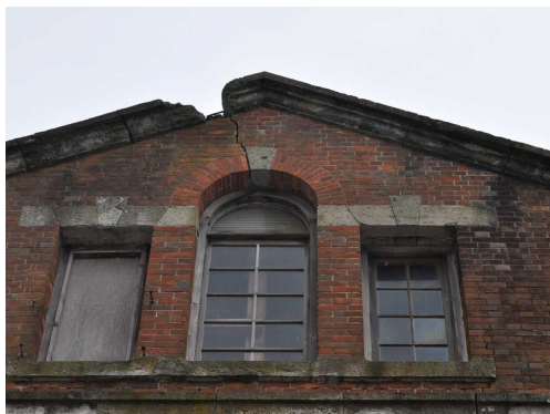
9 火力発電所発電機室 破損部
