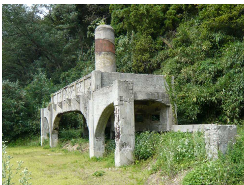
13 キューボラ コンクリート劣化部
