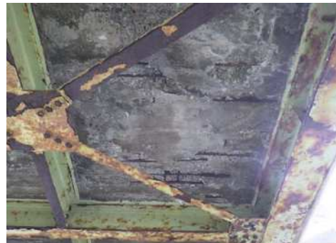
コンクリート床版の剥離・鉄筋露出等 (夷2号橋)
