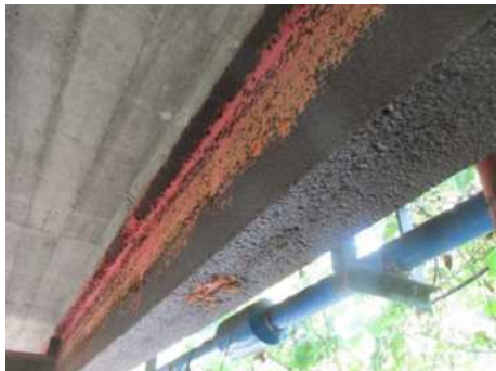
鋼桁の腐食等 (馬首1号橋)
