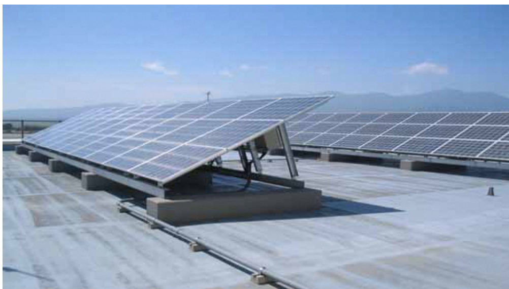
太陽光パネル
