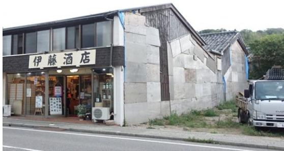
個人商店 壁面修理工事前
