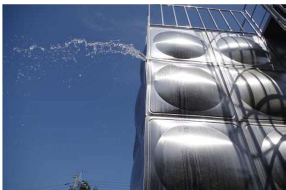
SUS 配水池破損(熊本地震)
