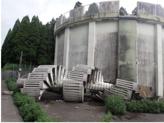
PC 配水池階段倒壊(熊本地震)
