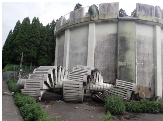
PC 配水池階段倒壊（熊本地震）
