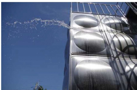
SUS 配水池破損(熊本地震)
