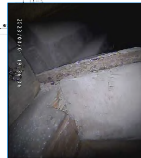
■東側仕口(南より見る) 大梁に対して大引きを大入れとし、上部をカスガイ留めとしていることがわかる。 西側の仕口と異なり、大梁の上に根太と同方向に入る調整材は、当仕口上部で切り離れて西側と東側で別材となっている。構造的な大きな弱点とはならないと考えるが、当該箇所1点に床積載荷重が集中しないよう注意する必要がある。
