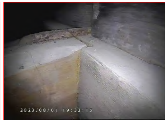
■西側仕口(北より見る) 仕口側面が隙間なく納まっていることから、設置後にズレは生じていないと考えられる。
