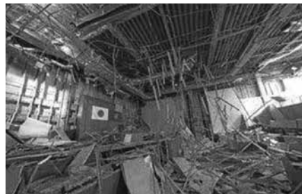
壊滅状態となった議場
