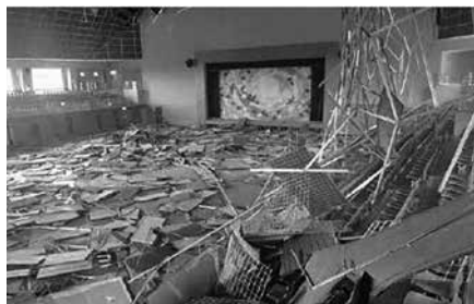
避難所の天井パネル、照明など落下
