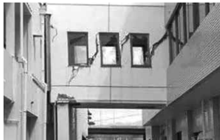
外壁の大きな亀裂
