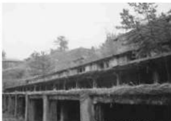
▲現在の様子 屋根がなく、朽ちている
