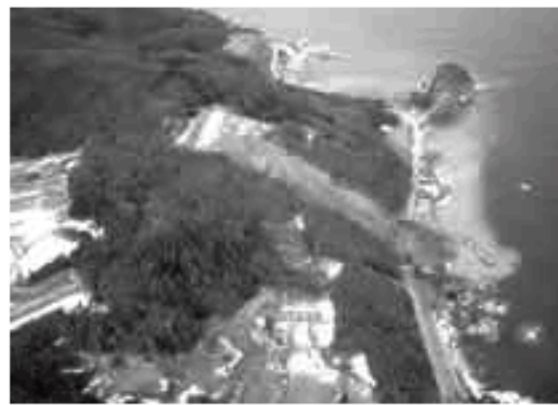
(写真は平成15年1月18日に発生した片野尾地すべり災害) 佐渡地域振興局農林水産振興部森林施設課により地すべり対策工事中
