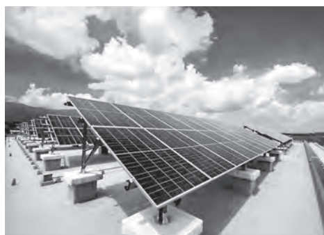
市役所新庁舎屋上に設置した太陽光パネル
