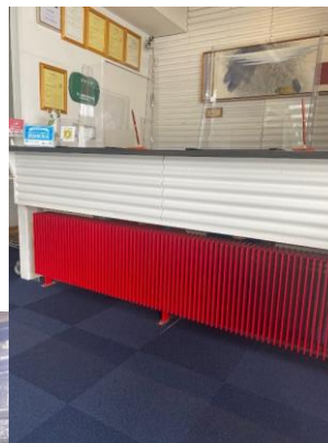
排熱を活用した ヒーターの設置
