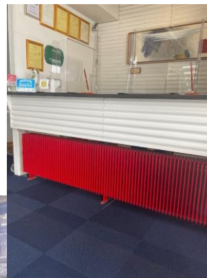
排熱を活用した ヒーターの設置
