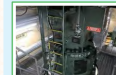
残留熱除去設備 (各号機3台)
