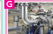
+ 高圧代替注水ポンプ (制御電源不要)
