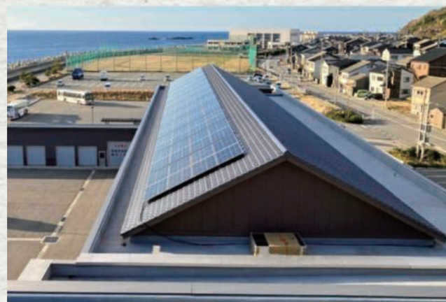
▲ 庁舎に設置したソーラーパネル
