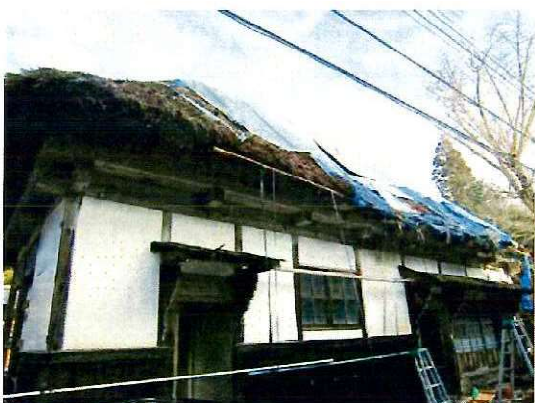
写真20 屋根の劣化 茅屋根にシートで雨漏り対策が為されているが、経年によりズレや劣化が進み、雨漏りを防ぎきれていない。
