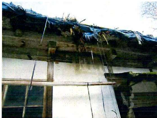
写真18 桁の雨染み 桁に雨染みが発生している。写真15のように合掌から伝った雨水によるものと思われる。
