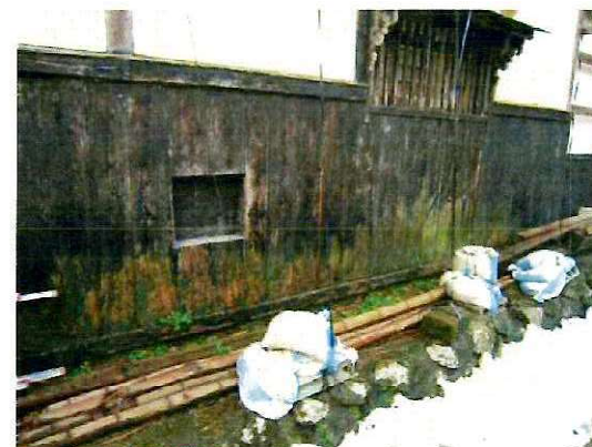
写真23 腰壁の劣化 腰壁が劣化し、苔が繁殖している。
