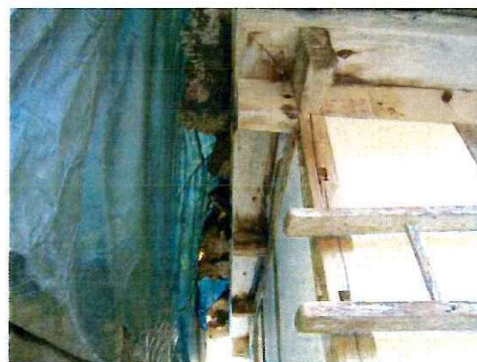
写真22 軒先の劣化 茅屋根の軒先が劣化し、腐朽している。放置すると茅負などの部材にも影響があることが懸念される。
