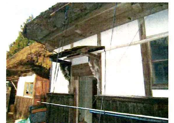
写真24 板底の割れ 板底の屋根板が腐朽し、割れが発生している。
