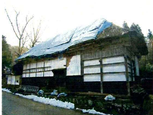
写真21 外壁の劣化 腰壁に雨水の跳ね返りによる劣化が見られる。
