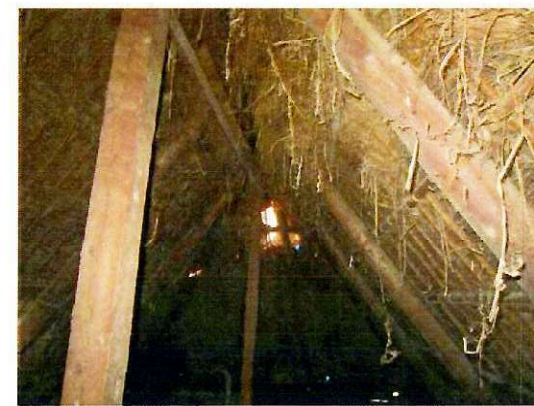
写真16 茅のズレ 棟付近の茅がズレて穴があいている。
