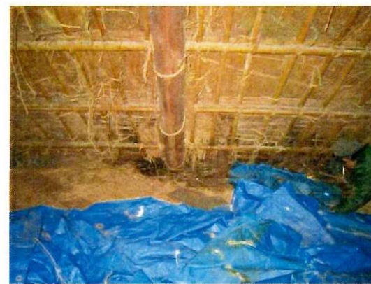
写真15 合掌廻りの腐朽 茅のズレによって雨水が合掌を伝って浸入して、茅負、桁を腐朽させる原因となっている。
