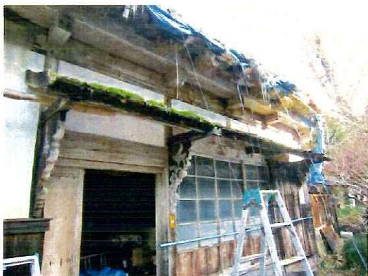
写真19 下屋の杉皮の腐朽 杉皮葺の下屋が劣化し、桁が腐朽している。
