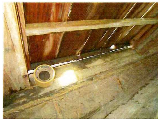
写真14 土台の雨染み 土台に外壁から伝った雨水が到達して吸水させている。 कारणで腐朽は免れている。
