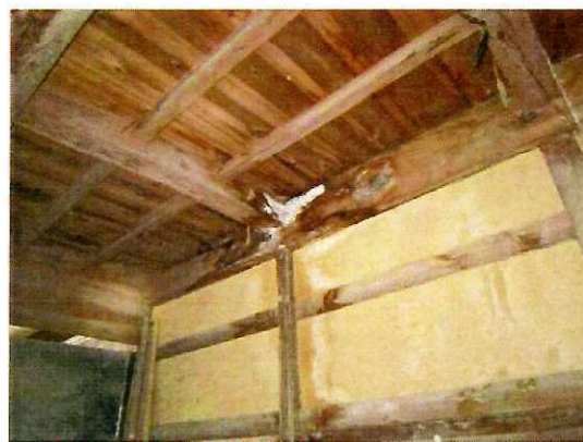
写真13 桁・柱頂部の腐朽 雨漏りにより柱や桁に腐朽が発生し、カビが繁殖している。雨漏りは現在進行中である。
