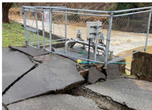
取水口被害状況(珠洲市)
