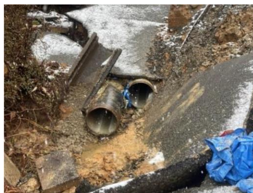
送水管損傷(輪島市)
